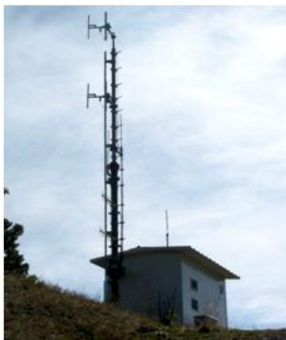
Monte Zoncolan [Shelter e palo porta antenne]
