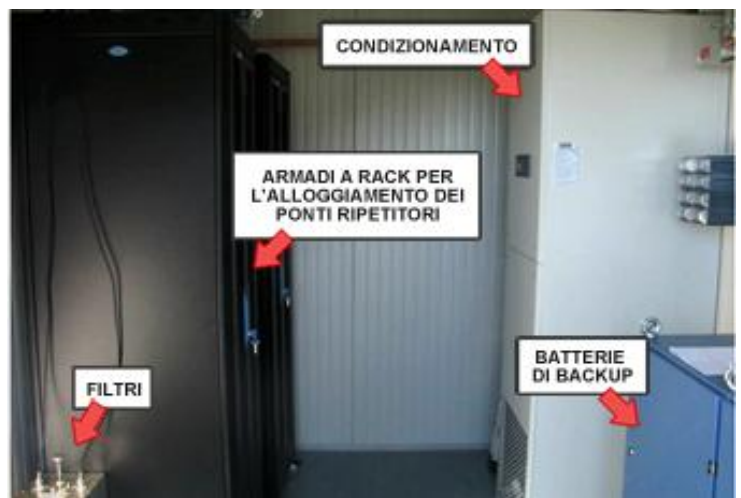
Monte Zoncolan [Allestimento interno shelter]
